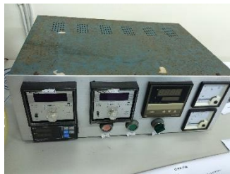
設備名稱：P. I. D溫度 控制器 設備用途：控制加熱器、 顯示溫度 設備位置：工EV 3008
